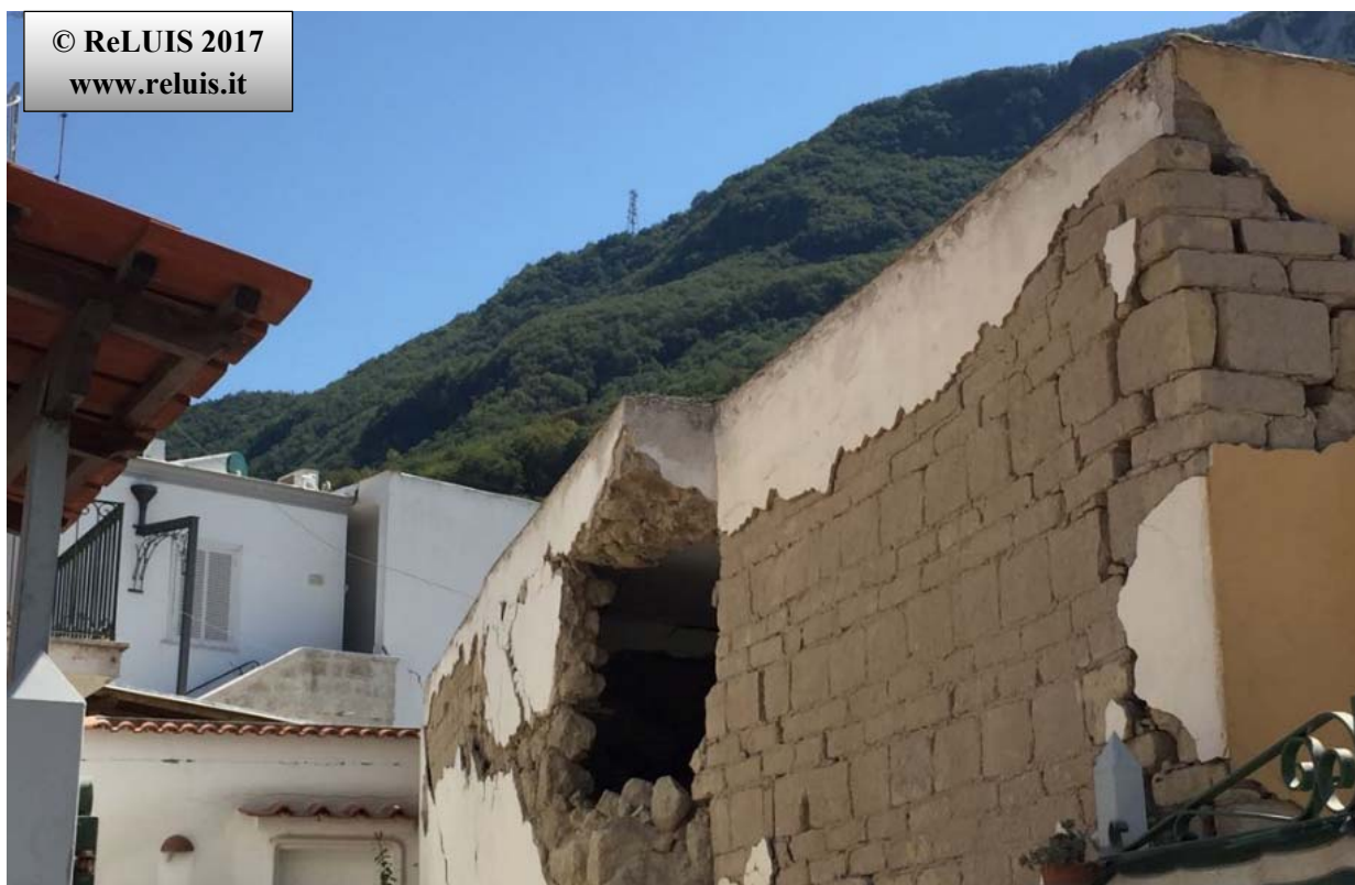
Edificio in Muratura - Località la Rita – Casamicciola Terme Ribaltamento fuori piano del cantonale
