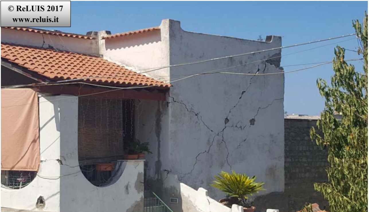
Edifici in Muratura - Via Montecito, Piazza Maio – Casamicciola Terme Lesioni a taglio nella muratura portante
