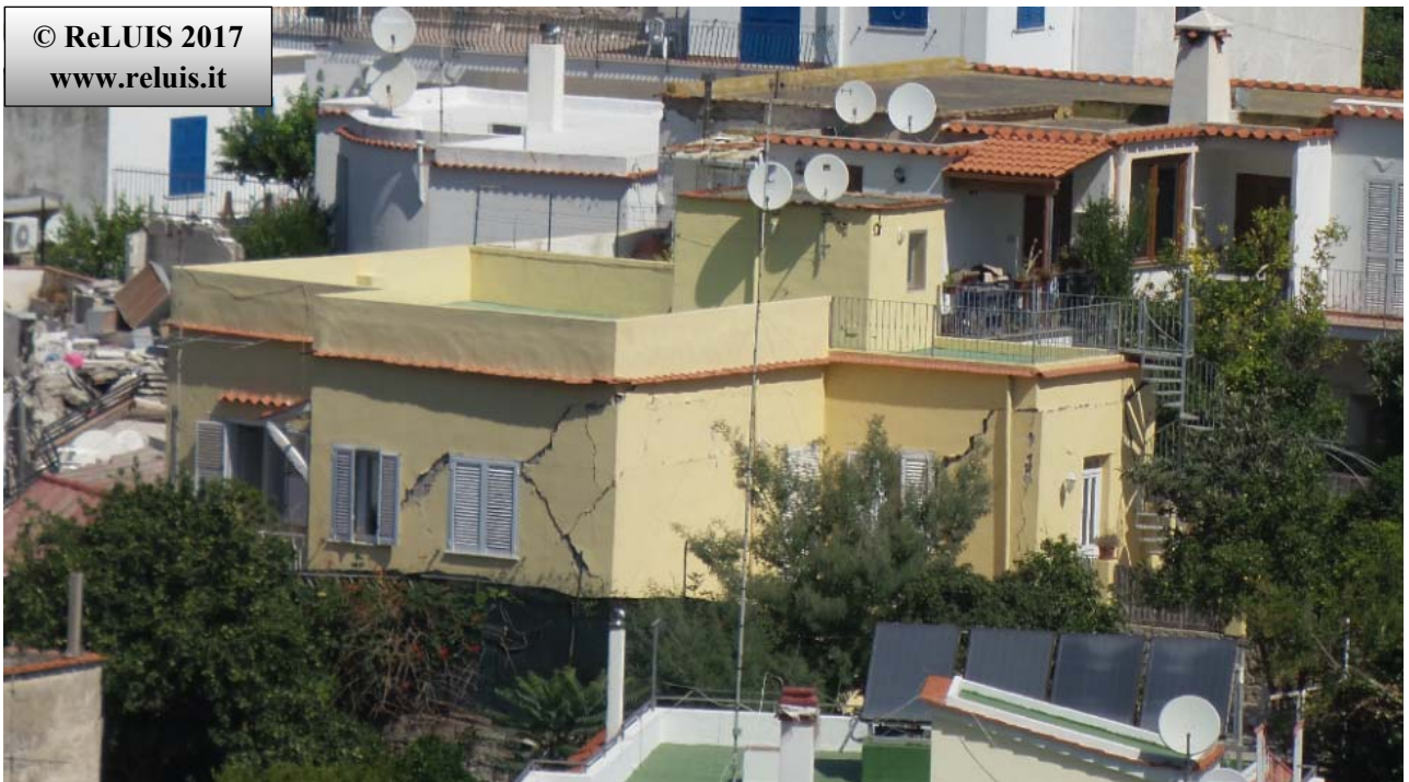
Edificio in Muratura - Via D'Aloisio, Piazza Maio – Casamicciola Terme Lesioni da taglio nel piano della parete
