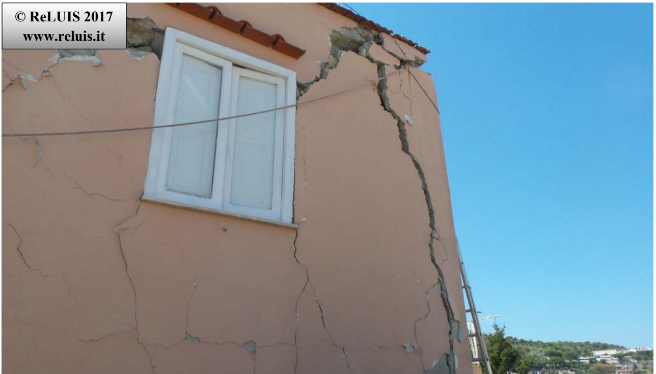
Edificio in Muratura - Via Montecito, Piazza Maio – Casamicciola Terme Ribaltamento del cantonale
