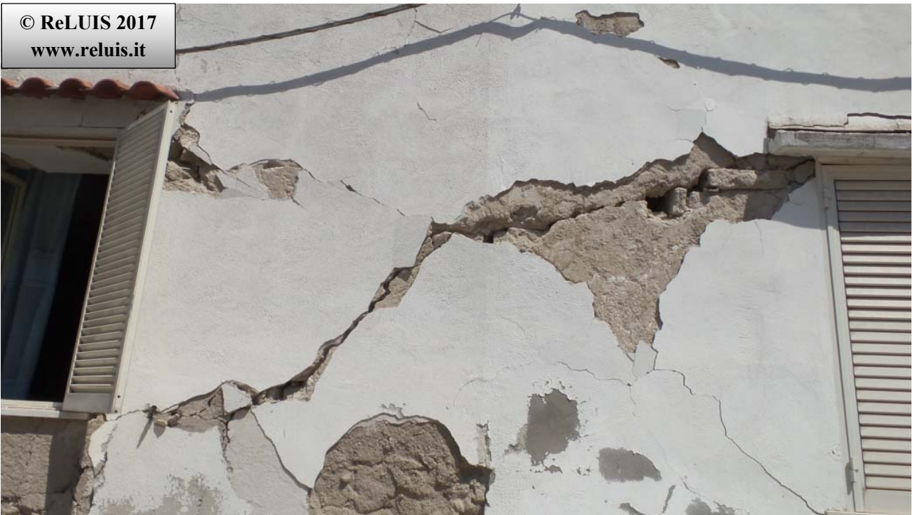
Edificio in Muratura - Località la Rita – Casamicciola Terme Lesioni taglio di maschi murari
