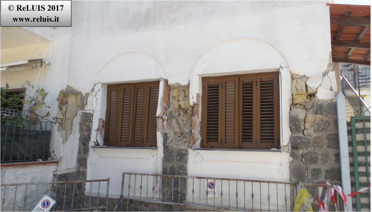
Edificio in Muratura - Località la Rita – Casamicciola Terme Lesioni di schiacciamento di pilastri in muratura
