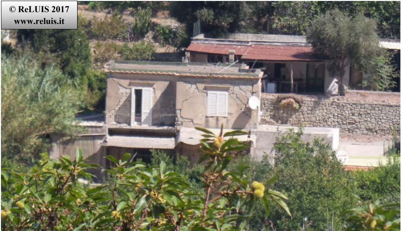
Edificio in Muratura - Via D'Aloisio, Piazza Maio – Casamicciola Terme Lesioni da taglio in corrispondenza delle aperture
