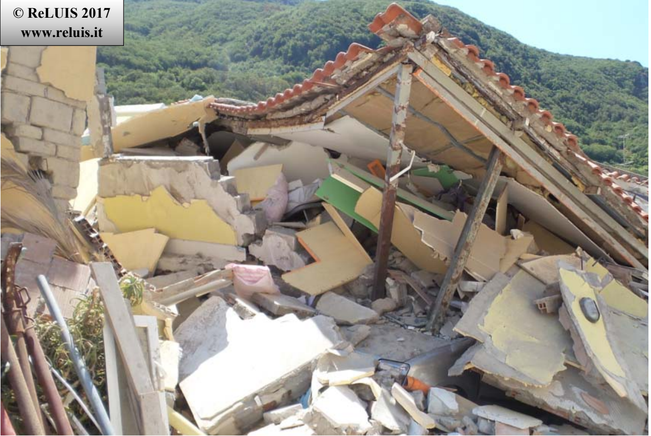
Edificio in Muratura - Località la Rita – Casamicciola Terme Crollo palazzina
