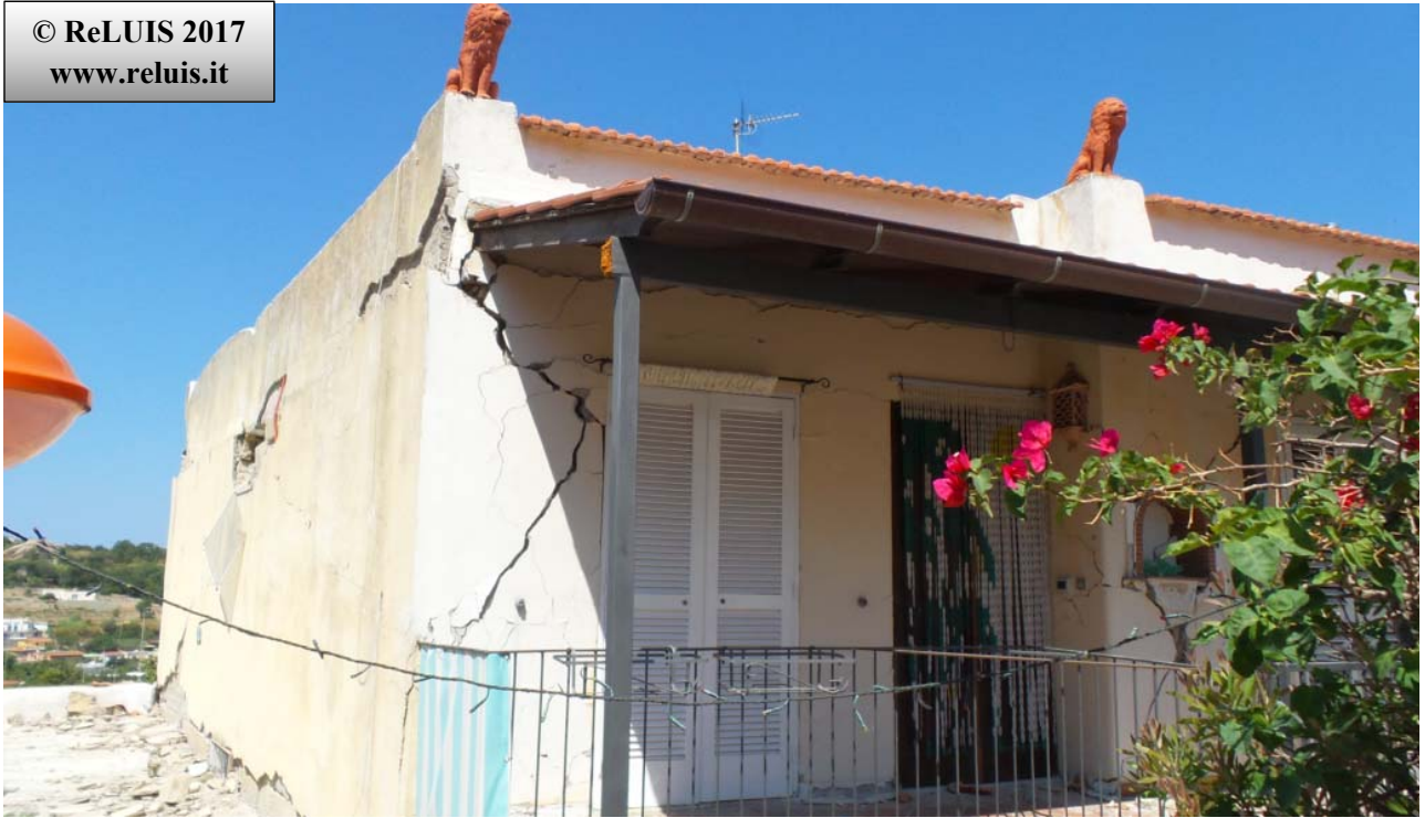
Edificio in Muratura - Via Montecito, Piazza Maio – Casamicciola Terme Lesioni da taglio nel piano della parete
