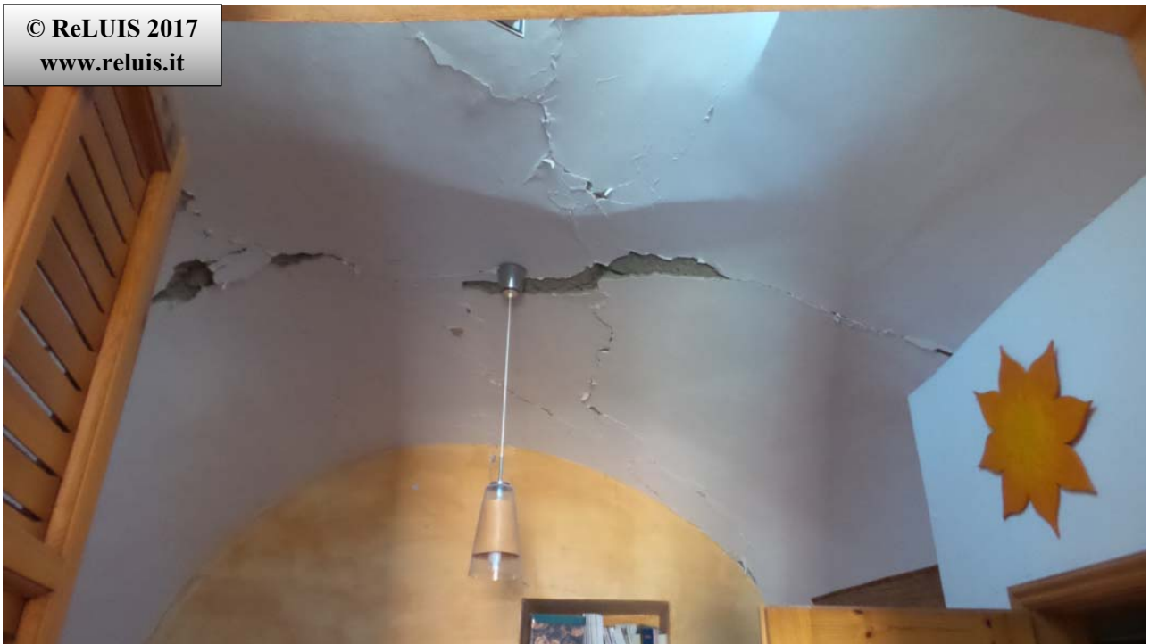
Edificio in Muratura - Via Spezeria, Piazza Maio – Casamicciola Terme Lesioni sulle volte in muratura
