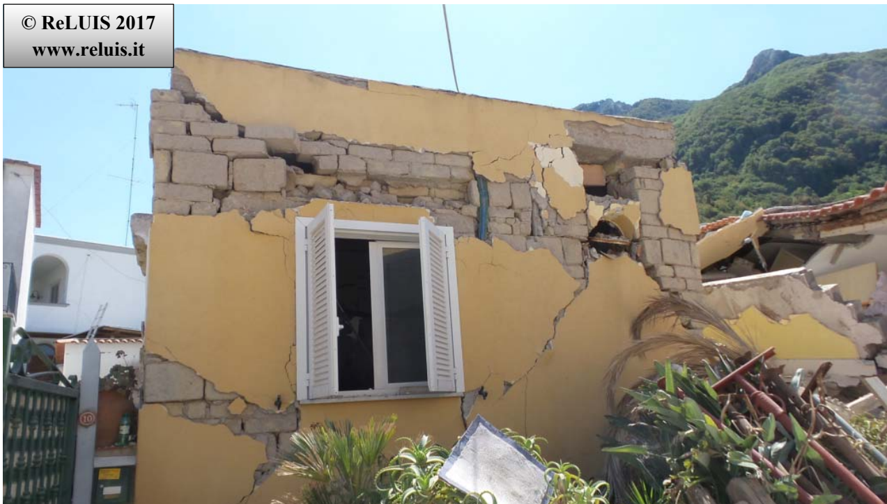
Edificio in Muratura - Località la Rita – Casamicciola Terme Lesioni nel Cantonale e nel piano della facciata
