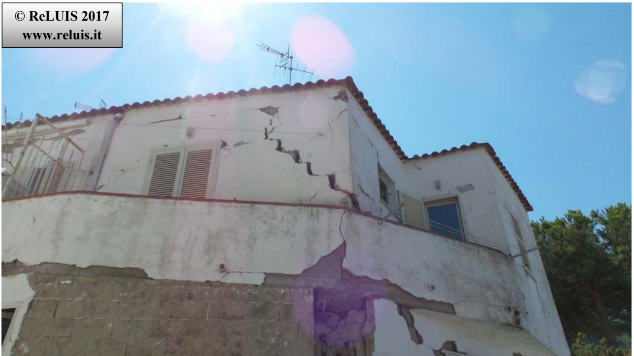
Edificio in Muratura - Località la Rita – Casamicciola Terme Ribaltamento composto di facciata
