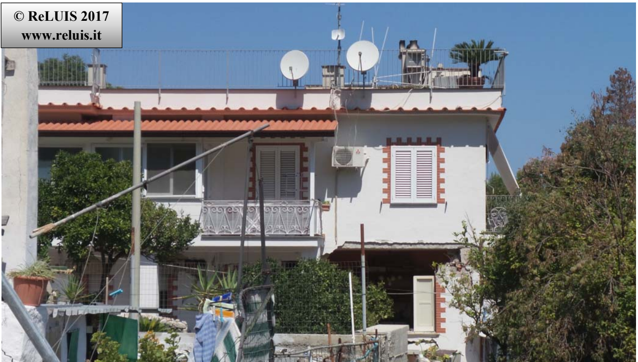
Edifici in Cemento Armato- Via Nizzola, Piazza Maio – Casamicciola Terme Espulsione Tamponatura
