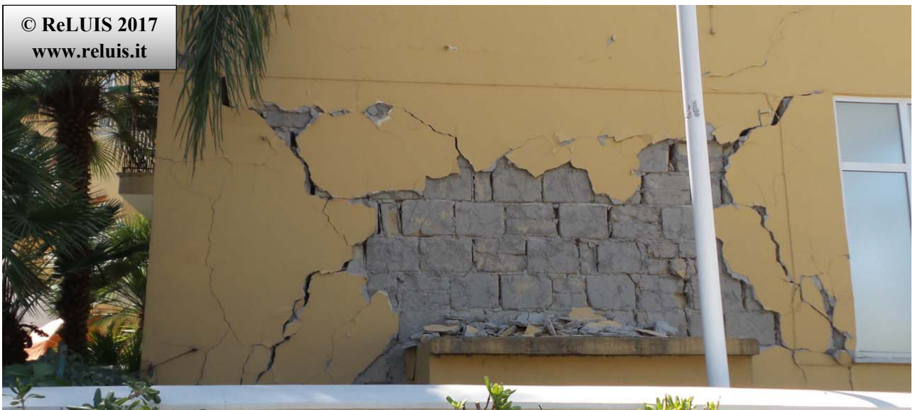
Edificio in Muratura - Località la Rita – Casamicciola Terme Lesioni taglio di maschi murari
