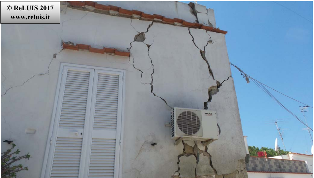
Edificio in Muratura - Località la Rita – Casamicciola Terme Lesioni nel Cantonale
