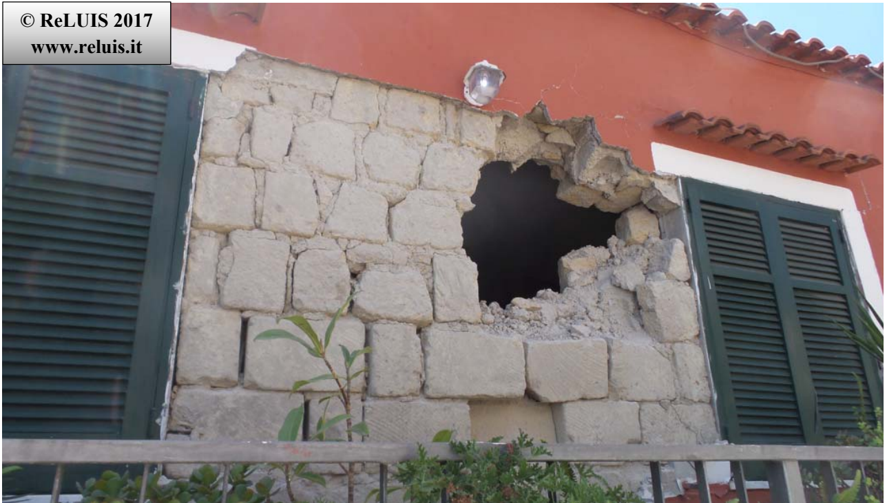
Edificio in Muratura - Via Nizzola– Casamicciola Terme Lesioni nel piano della parete con espulsione di muratura
