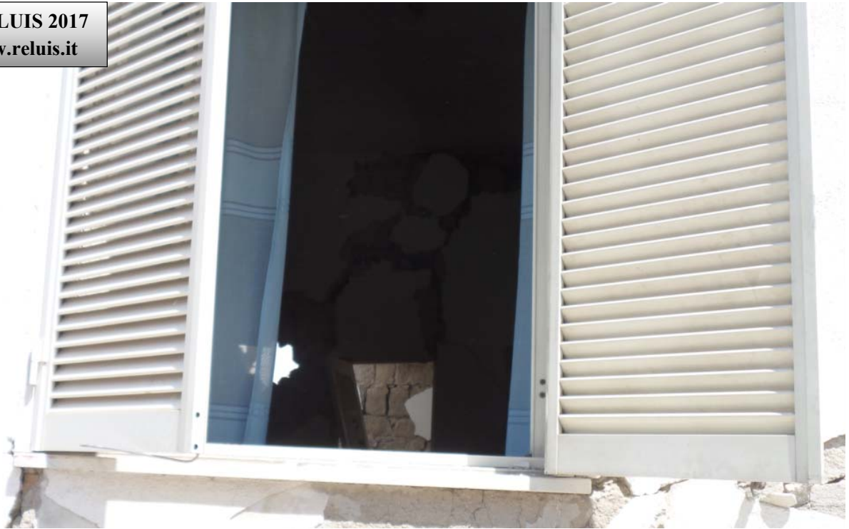
Edificio in Muratura - Località la Rita – Casamicciola Terme Lesione della parete in corrispondenza dell'apertura
