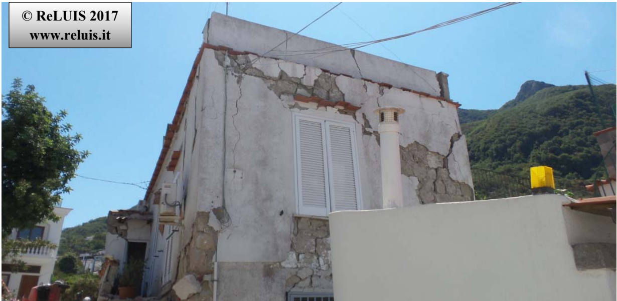
Edificio in Muratura - Località la Rita – Casamicciola Terme Lesioni nel Cantonale e nel piano della facciata
