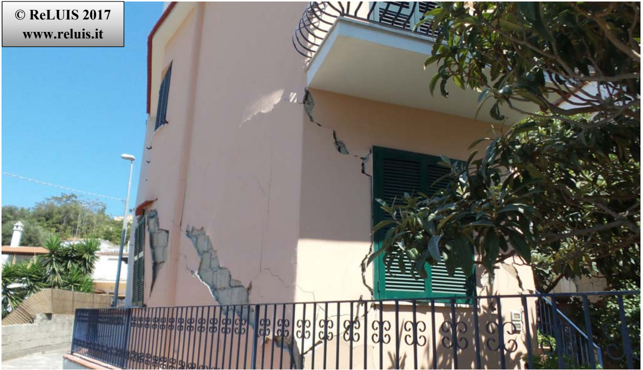
Edificio in Muratura - Località la Rita – Casamicciola Terme Lesioni da taglio in corrispondenza delle aperture
